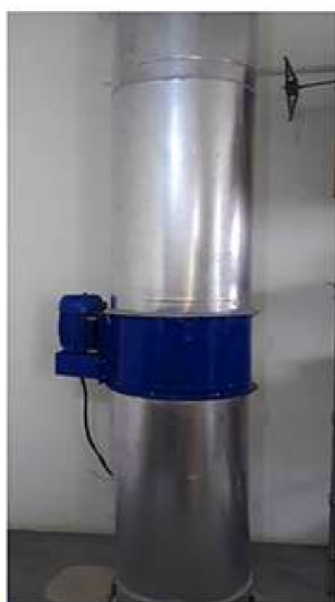
SISTEMA DE EXAUSTÃO COM EXAUSTOR AXIAL DE TRANSMISSÃO
